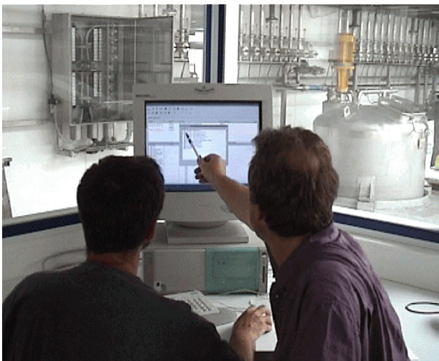
Abbildung 2: Leittechnikarbeitsplatz mit Chargenplanung
